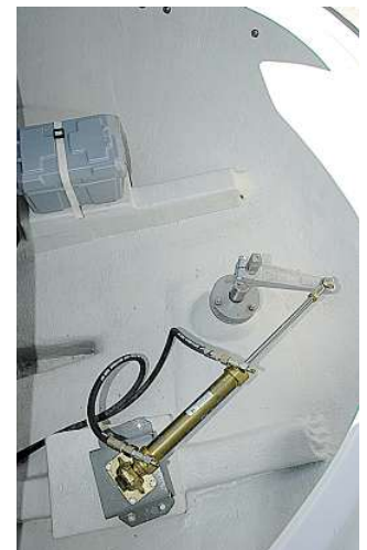
Im großen Heckstaukasten befindet sich die Batterie
